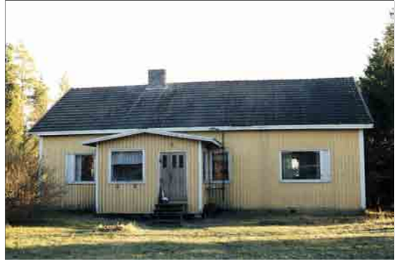
Asuinrakennus ennen korjausten aloittamista. Rakennus on pohjamuodoltaan suorakaide ja siihen liittyy kylmä kuistiosa.
