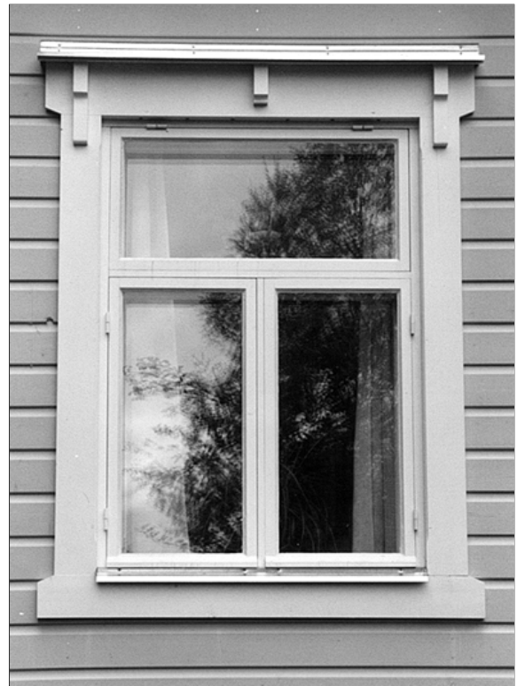
Ikkunakarmi on kiinnitetty lähelle ulkopintaa, tuuletusvälin tuntumaan. Syryyttä pienennettiin lisäksi viistämällä vuorilautojen sisäsivut.
